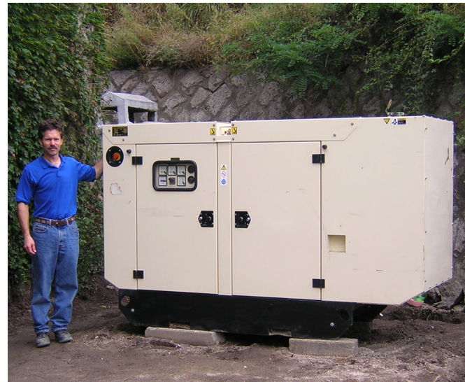
새롭게 설치된 발전기의 모습
