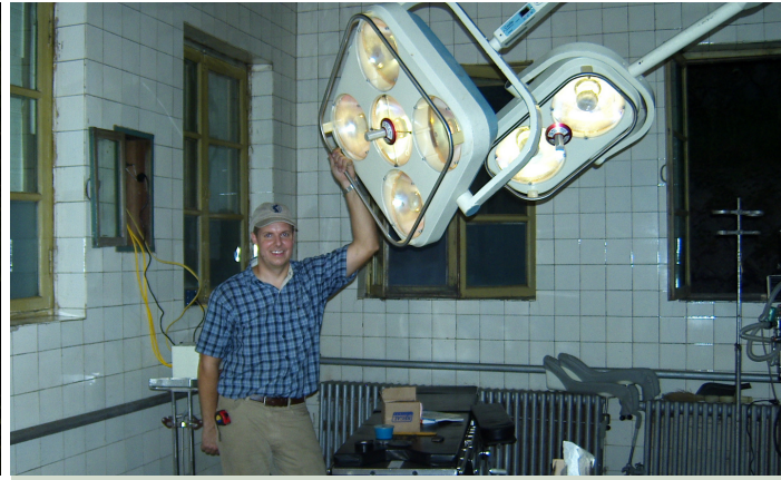
새롭게 설치된 수술실 조명의 모습
